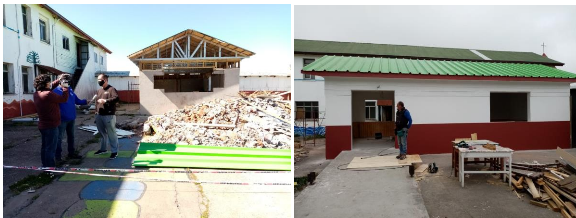
Remodelación de sala para el Centro, Escuela San Sebastián, comuna de Saavedra
