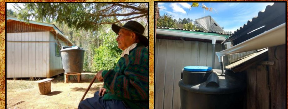
Figura 2. Sistemas de captación de aguas lluvia instalados en las viviendas de la comunidad. Vivienda de Don Merardo Collinao (izquierda) y de Don Segundo Collinao (derecha).
